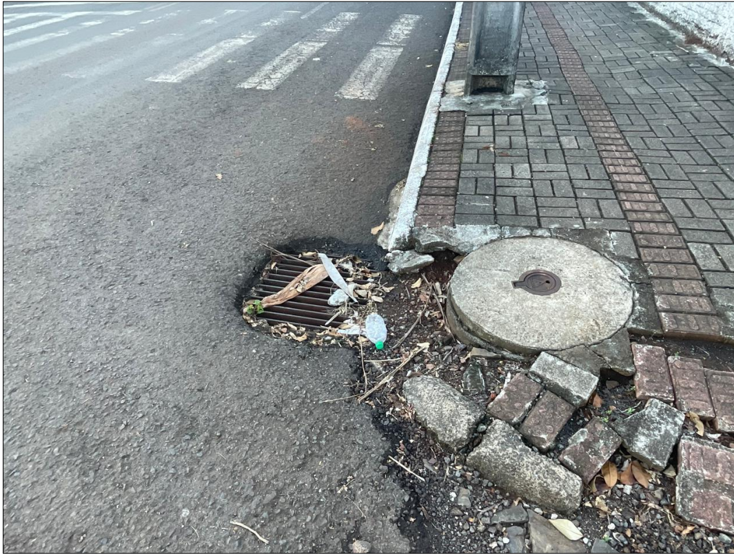
Figura 29 – Bocas de Lobo em más condições de conservação.
