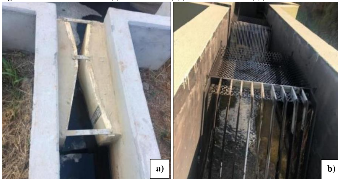
Figura 32 – Estruturas da ETE: (a) Calha Parshall; (b) Grade média e fina; (c) Reatores UASB.
