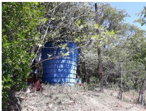
Figura 45 - Local do poço e caixa que abriga o aparelho dosador e o galão de cloro (50L).
