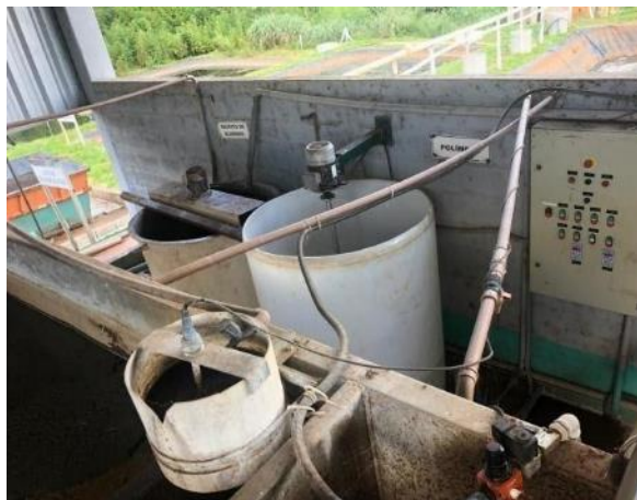
Figura 88 - ETE – Físico -químico.
