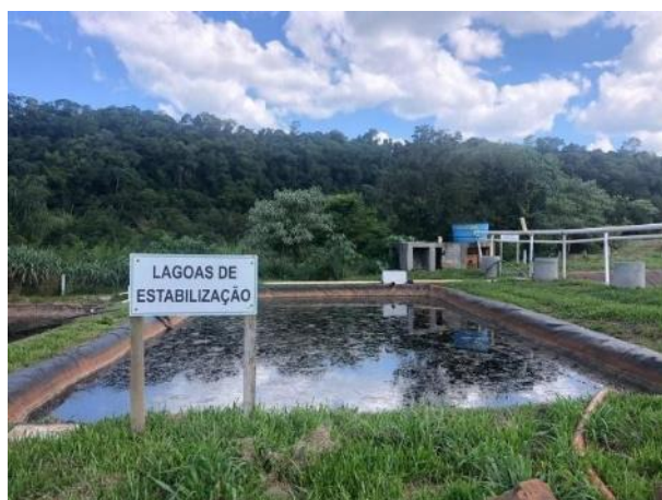
Figura 85 - Lagoa de estabilização.
