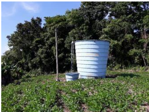
Figura 49 - Local do reservatório da associação e caixa que abriga o aparelho dosador e o galão de cloro.
