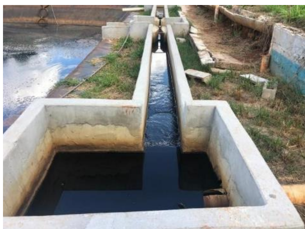
Figura 84 - Caixa de chegada de chorume.
