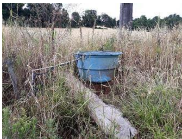
Figura 33 - Local da caixa que abriga o aparelho dosador de cloro.
