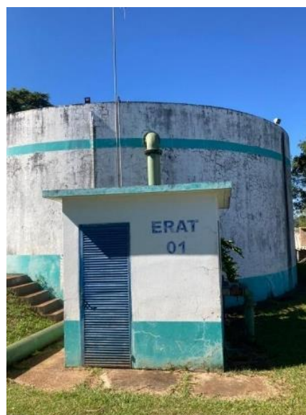
Figura 10 - Reservatório de Água Tratada dentro da ETA.
