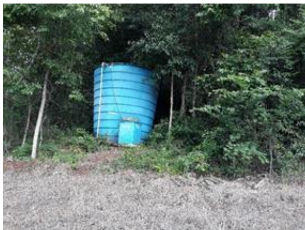
Figura 46 - Local da caixa que abriga o aparelho dosador e o galão de cloro e caixa de distribuição da associação.
