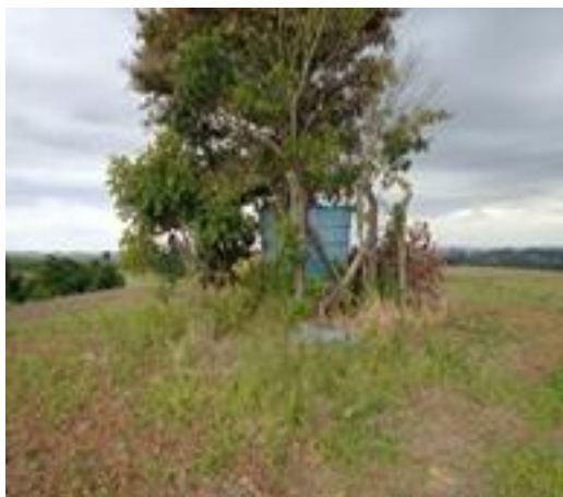
Figura 37 - Caixa de recalque.
