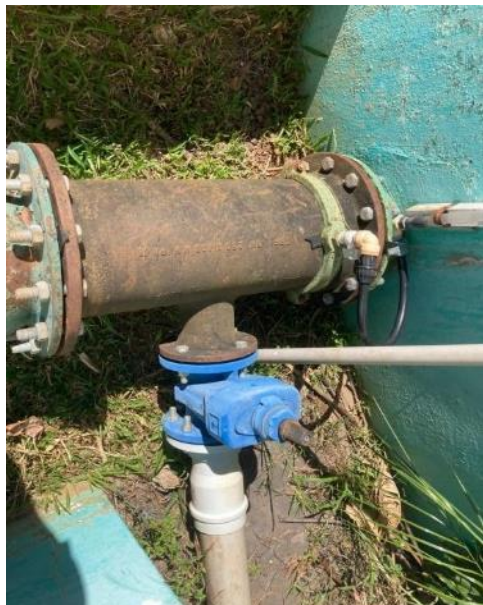
Figura 7 - Sistema hidráulico da ETA.
