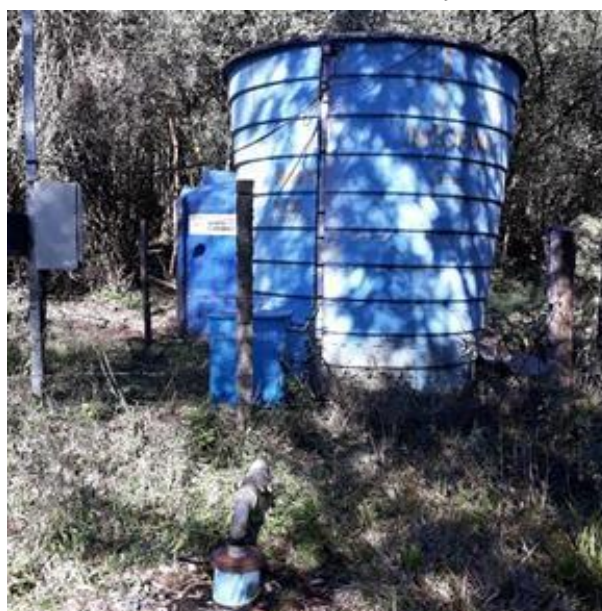
Figura 50 - Local do poço, dois reservatórios e da caixa com aparelho dosador da associação.
