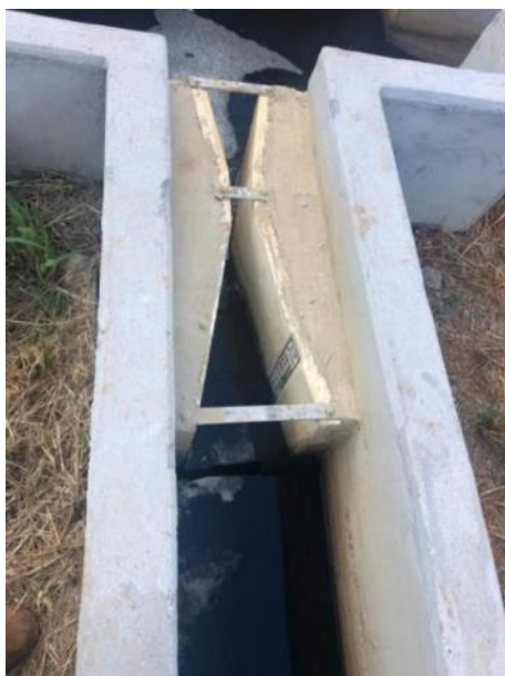
Figura 65 - Medidor de vazão Calha Parshall.
