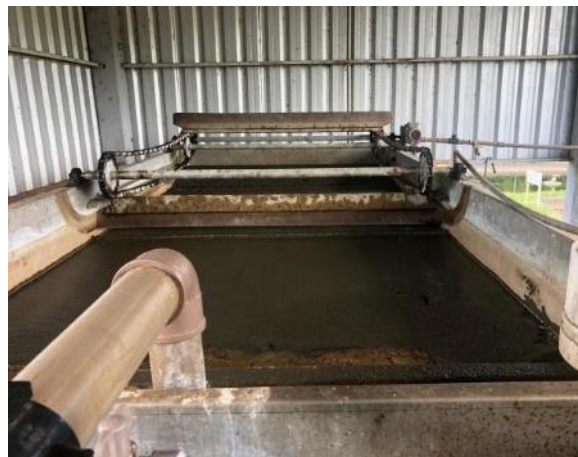
Figura 89 - Tanque de passagem de chorume.
