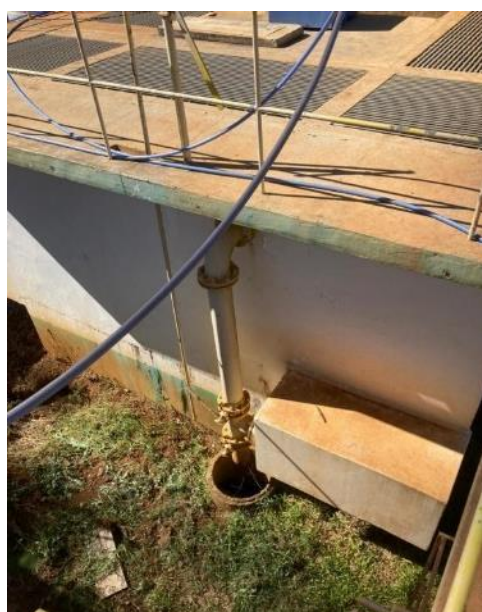
Figura 5 - Tubulação de saída de lavagem dos filtros.
