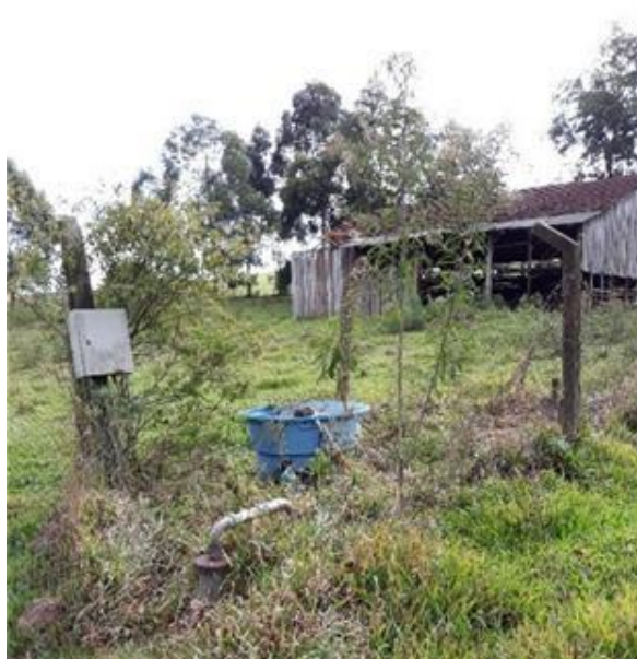
Figura 54 - Local do poço e caixa que abriga o aparelho dosador e o galão de cloro.
