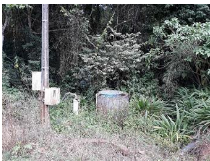
Figura 44 - Local do poço e caixa que abriga o aparelho dosador e o galão de cloro (50L)
