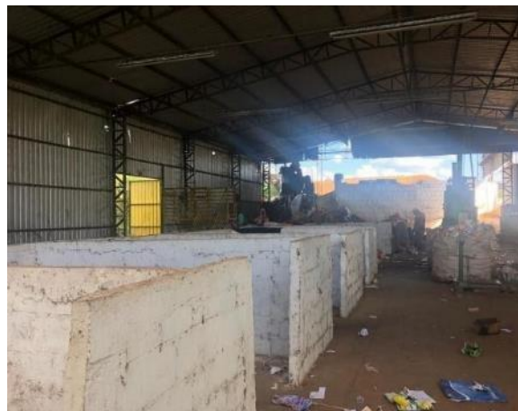
Figura 94 - Baías de segregação de materiais recicláveis.
