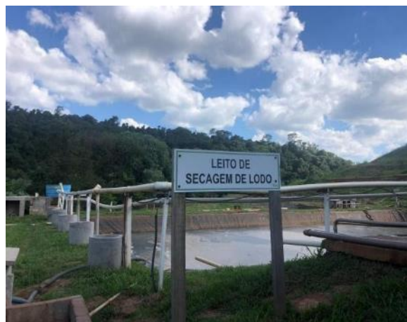
Figura 87 - Leito de secagem de lodo.
