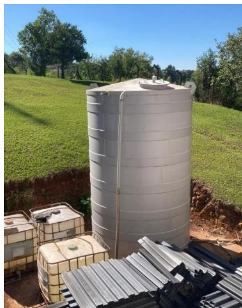
Figura 4 Tanque de armazenamento de Cloro.
