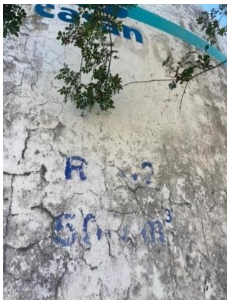
Figura 16 - Reservatório R1 localizado no pátio da ETA.
