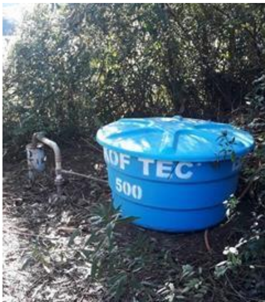
Figura 34 - Local da caixa que abriga o aparelho dosador de cloro.
