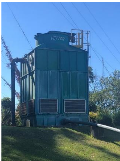
Figura 30 - Torre de resfriamento do sistema de Captação Subterrânea de Maravilha-SC.
