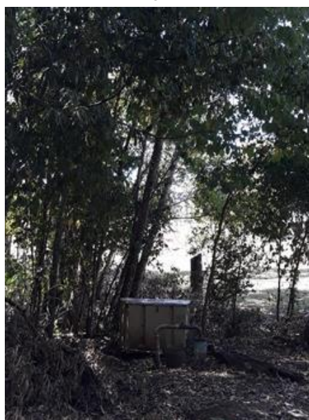
Figura 32 - Local do poço e da caixa que abriga o aparelho dosador e o galão de cloro.
