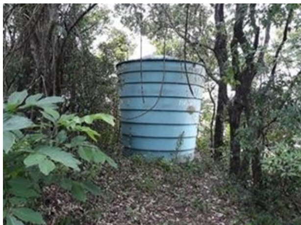
Figura 56 - Local da caixa de distribuição e caixa que abriga aparelho dosador.
