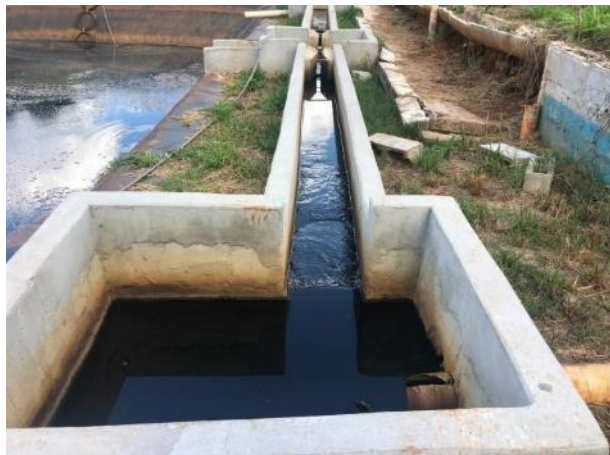
Figura 84 - Sistema de drenagem de chorume.
