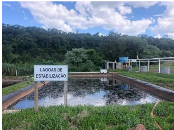
Figura 85 - Lagoa de estabilização.
