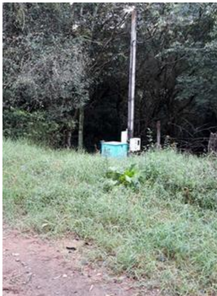
Figura 55 - Local do poço e caixa com aparelho dosador.
