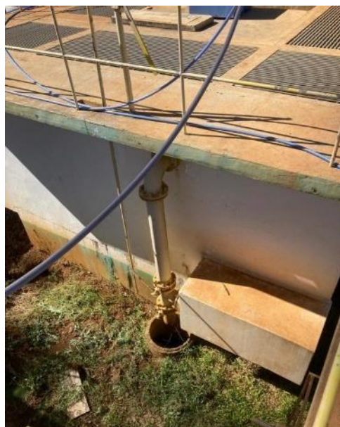
Figura 5 - Tubulação de saída de lavagem dos filtros.
