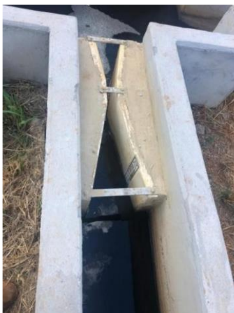
Figura 65 - Medidor de vazão Calha Parshall.
