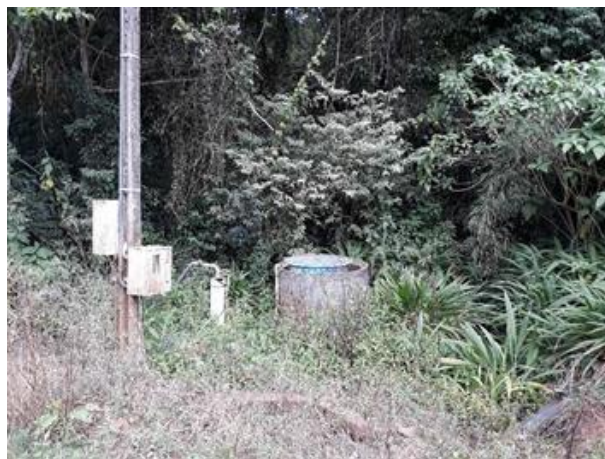
Figura 44 - Local do poço e caixa que abriga o aparelho dosador e o galão de cloro (50L)
