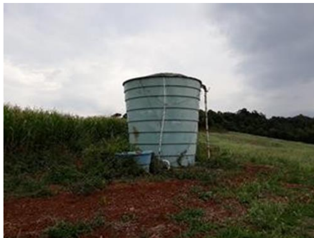
Figura 57 - Local da caixa e caixa que abriga o aparelho dosador e o galão de cloro.
