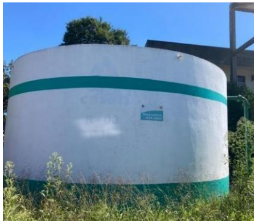
Figura 20 - Antigo reservatório R4.
