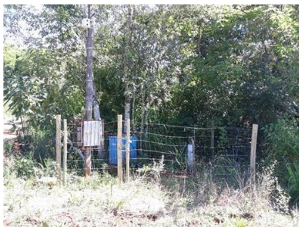
Figura 41 - Local do poço e da caixa que abriga o aparelho dosador e o galão de cloro.
