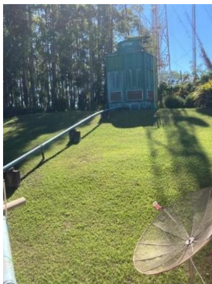
Figura 31 - Torre de resfriamento do sistema de Captação Subterrânea de Maravilha-SC.
