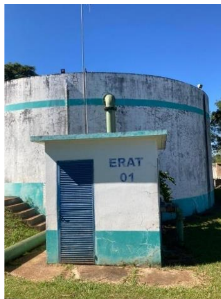
Figura 10 - Reservatório de Água Tratada dentro da ETA.
