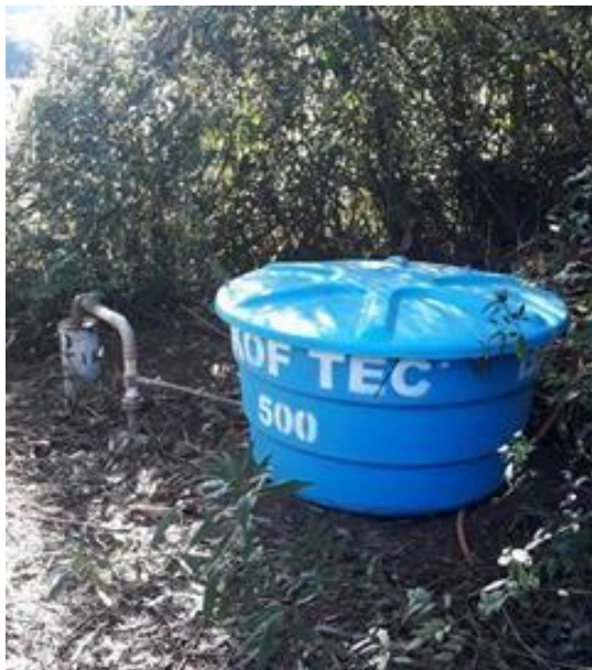
Figura 34 - Local da caixa que abriga o aparelho dosador de cloro.
