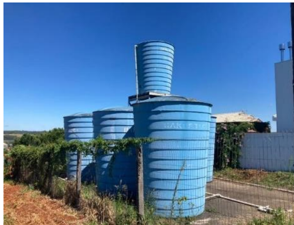
Figura 21 - Antigo reservatório R4.
