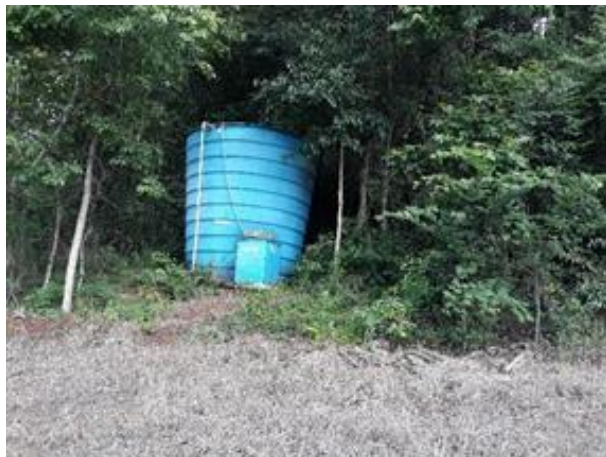
Figura 46 - Local da caixa que abriga o aparelho dosador e o galão de cloro e caixa de distribuição da associação.
