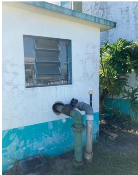
Figura 8 - Entrada da Tubulação na casa de Máquinas.
