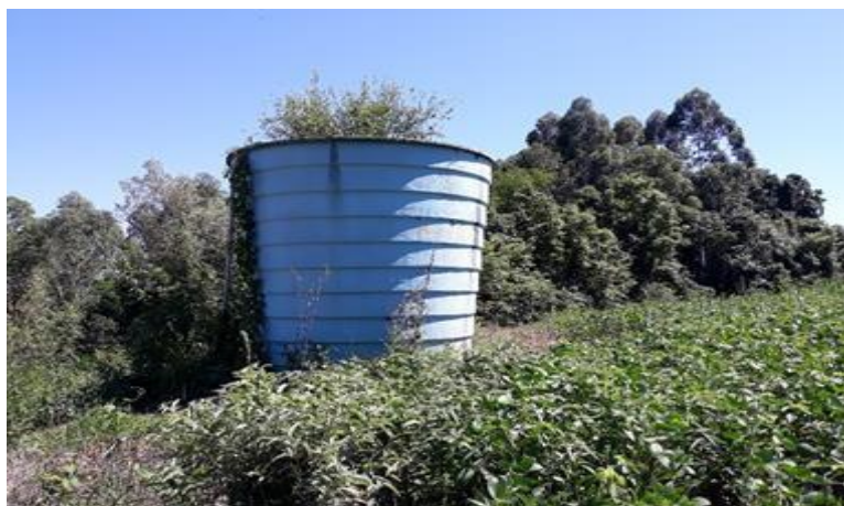
Figura 40 - Local do reservatório e da caixa que abriga o aparelho dosador e o galão de cloro.
