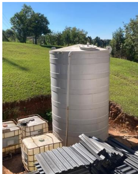
Figura 4 Tanque de armazenamento de Cloro.
