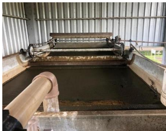
Figura 89 - Tanque de passagem de chorume.
