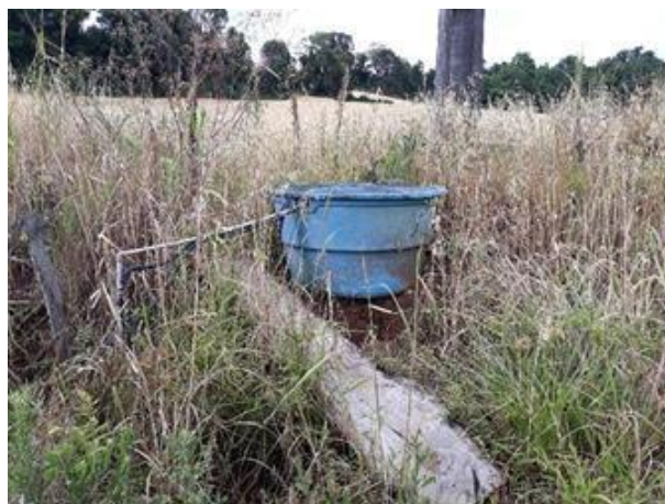
Figura 33 - Local da caixa que abriga o aparelho dosador de cloro.
