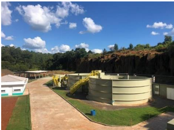
Figura 68 - Vista Geral da ETE de Maravilha.
