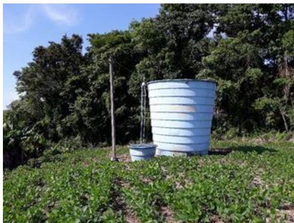
Figura 49 - Local do reservatório da associação e caixa que abriga o aparelho dosador e o galão de cloro.
