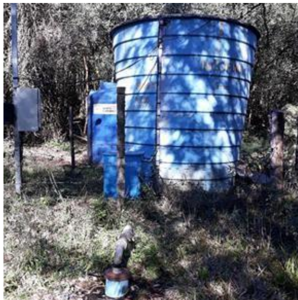
Figura 50 - Local do poço, dois reservatórios e da caixa com aparelho dosador da associação.
