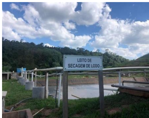
Figura 87 - Leito de secagem de lodo.
